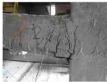
شکل ۴- خرابی تیر BS2 در اثر جداشدن CFRP از روی تیر و پارگی GFRP دور پیچ
