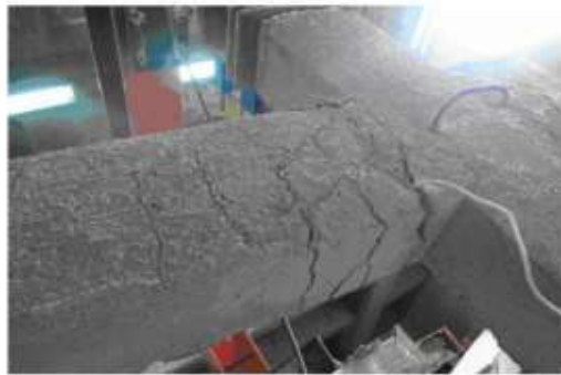
شکل ۲- خرابی و گسترش ترک در تیر کنترل (CB)
