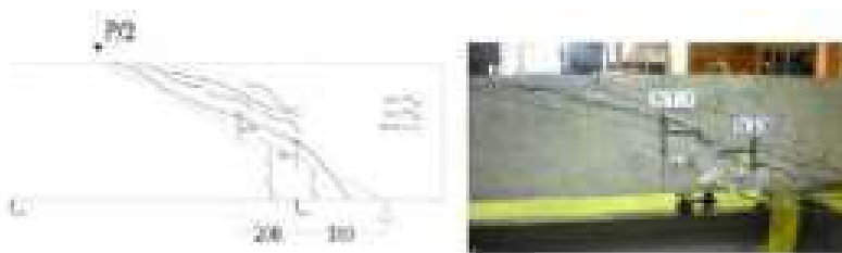
شکل ۲. مکانیزم ترک‌های ایجاد شده در تیر کنترل
